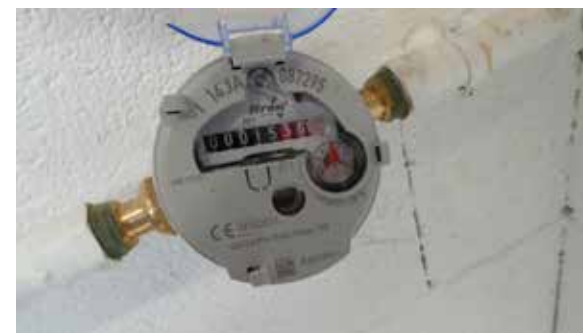
Sous-compteur d'eau pour gérer au plus près les postes de consommation
