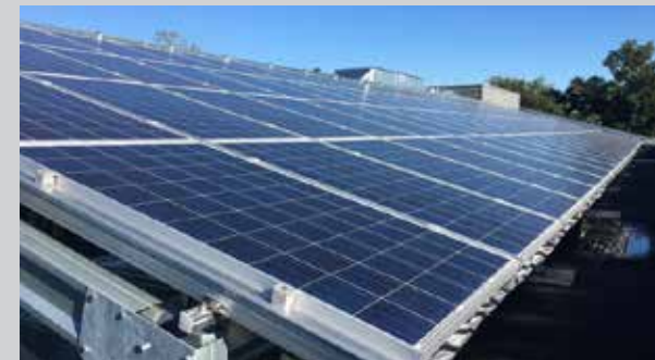
Toiture du CFA de la propreté : l'eau chaude et l'électricité seront fournies en partie par ce type d'installation solaire hybride
